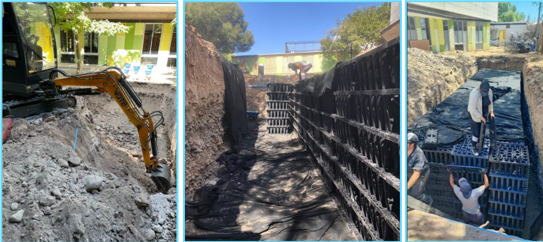
Drenaje de patios
